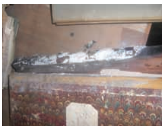
Documentación Afectada por Hongos
